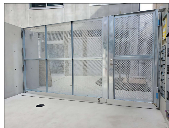
集合住宅 外部 門扉 スチール製 溶融亜鉛メッキ仕上
